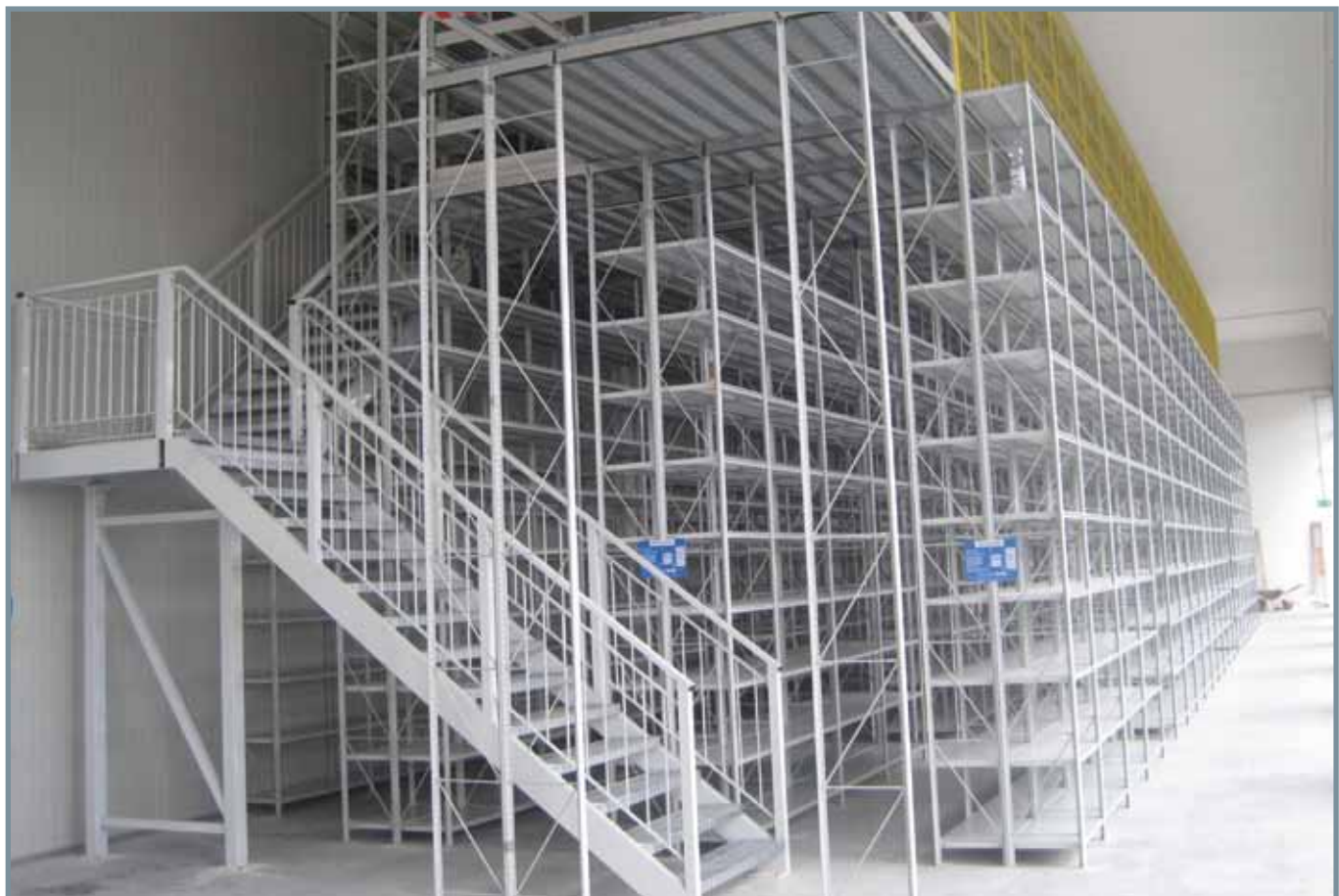
Vista impianto RI soppalcato
